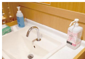
アルコール消毒液の設置
